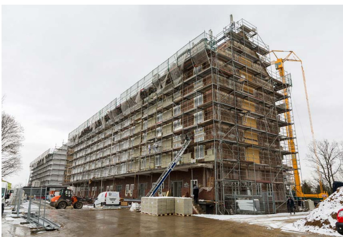
In Kassel begleitet die ProjektStadt die Sanierung des Magazin-hofs. © NHW Karsten Socher
